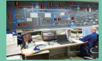
給水量等を調整する水道水の流通管理を 行っている
