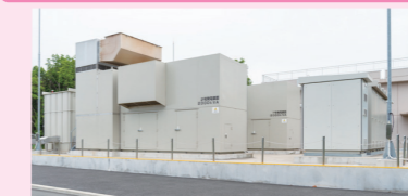
非常時に備えた発電設備の増強 新設の非常用発電設備
