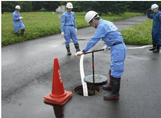
給水弁の操作
