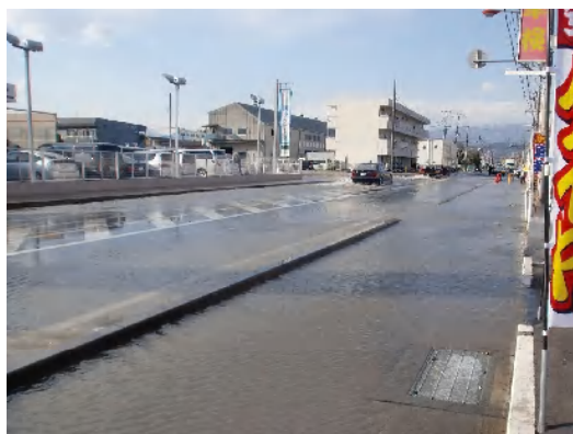
小田原市国道 255 号線における漏水状況
