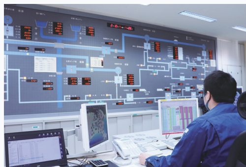
写真1 水運用センター 管理室
