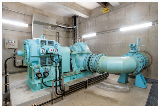
写真4 小水力発電*設備（水運用センター）
