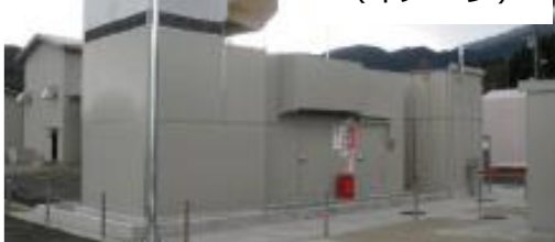
非常用発電機 (イメージ)
