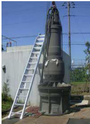
相模原浄水場着水井
