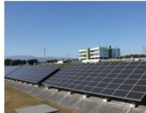
相模原浄水場
