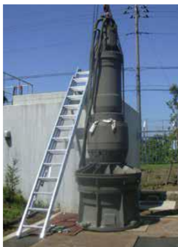
相模原浄水場着水井
