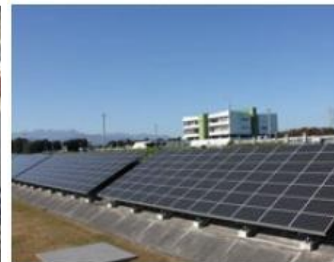
相模原浄水場
