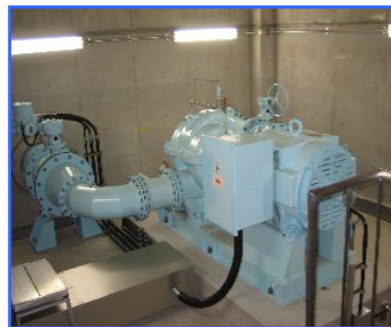
矢指小水力発電設備
