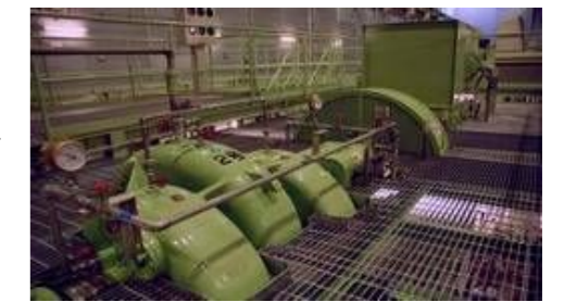
＜社家取水管理事務所ポンプ設備＞
