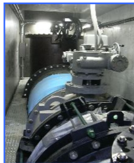
虹吹小水力発電設備
