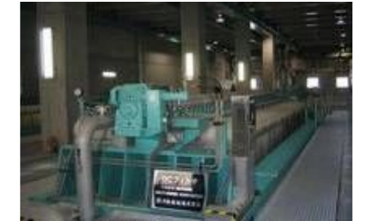
＜相模原浄水場排水処理施設＞
