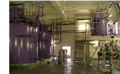
＜伊勢原浄水場酸注入設備＞
