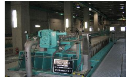
＜相模原浄水場排水処理施設＞
