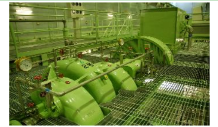
＜社家取水管理事務所ポンプ設備＞
