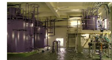
＜伊勢原浄水場酸注入設備＞
