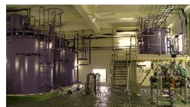
＜伊勢原浄水場酸注入設備＞
