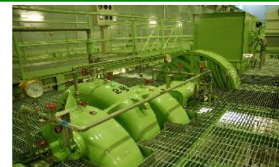
＜社家取水管理事務所ポンプ設備＞
