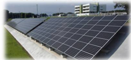
相模原浄水場太陽光発電設備
