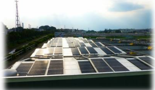
西長沢浄水場太陽光発電設備
