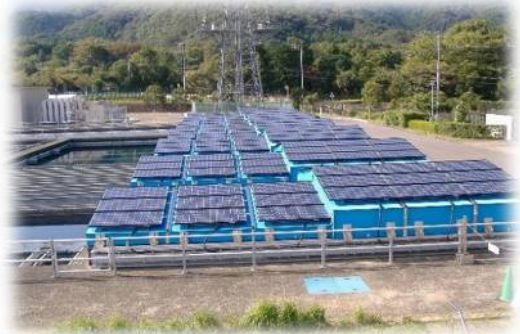
伊勢原浄水場太陽光発電設備
