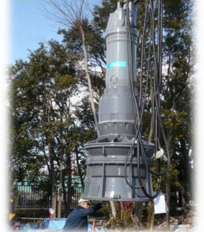
相模原小水力発電設備
