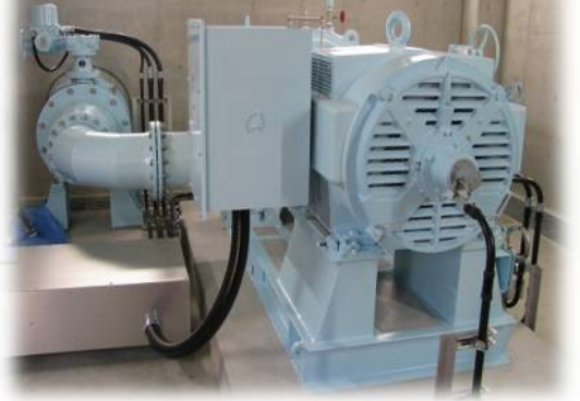
矢指小水力発電設備
