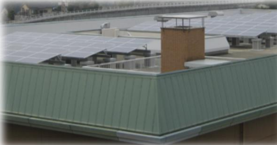
綾瀬浄水場太陽光発電設備
