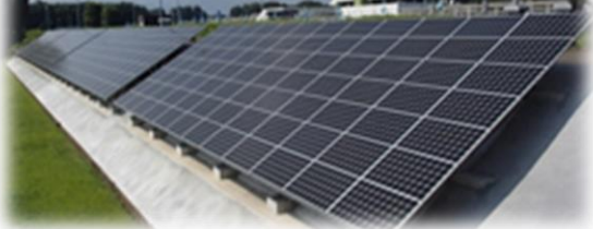
相模原浄水場太陽光発電設備
