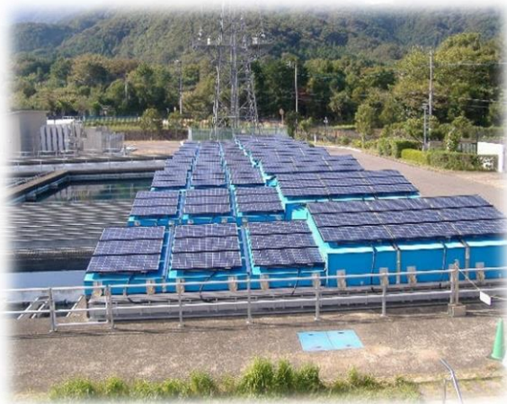
伊勢原浄水場太陽光発電設備
