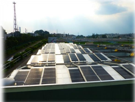
西長沢浄水場太陽光発電設備
