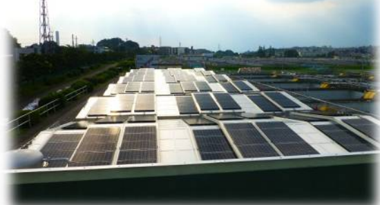
西長沢浄水場太陽光発電設備
