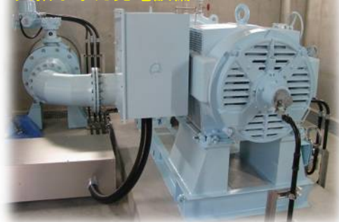
矢指小水力発電設備
