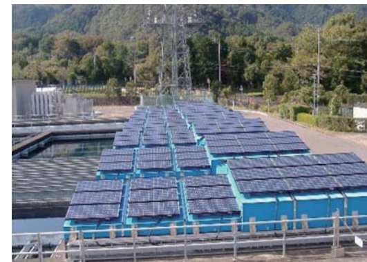
伊勢原浄水場太陽光発電設備
