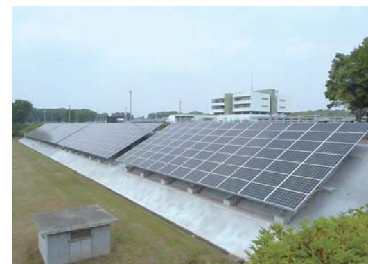
相模原浄水場太陽光発電設備
