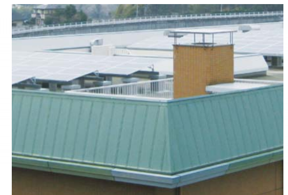
綾瀬浄水場太陽光発電設備
