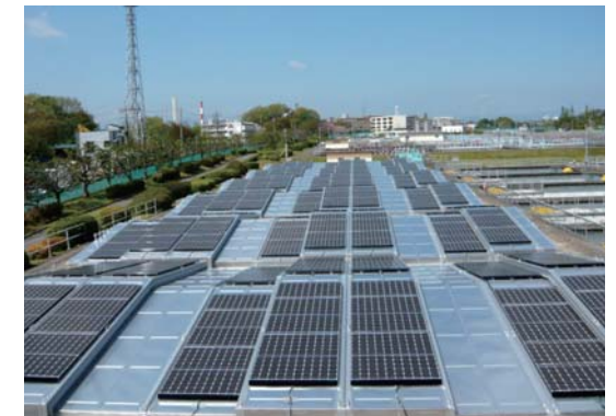
西長沢浄水場太陽光発電設備
