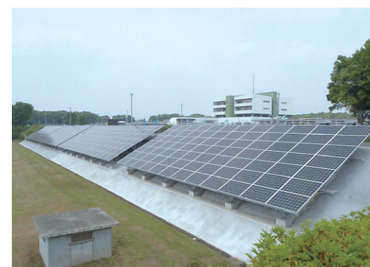
相模原浄水場太陽光発電設備
