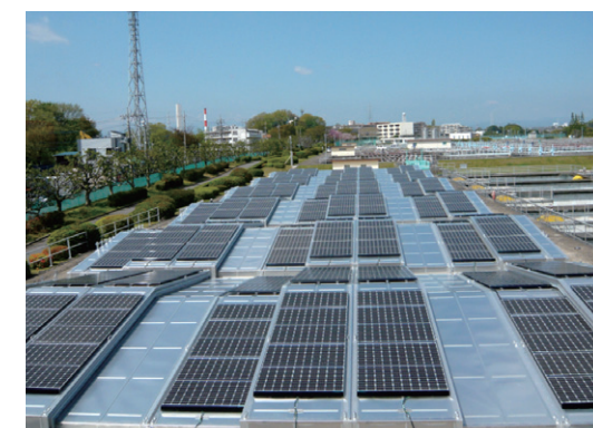
西長沢浄水場太陽光発電設備
