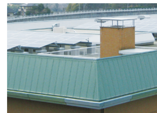
綾瀬浄水場太陽光発電設備
