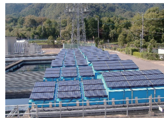
伊勢原浄水場太陽光発電設備
